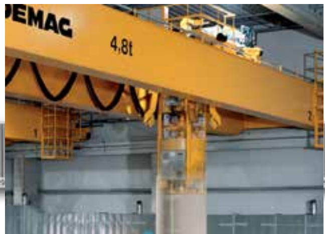
内部物流起重吊车的位置测定
